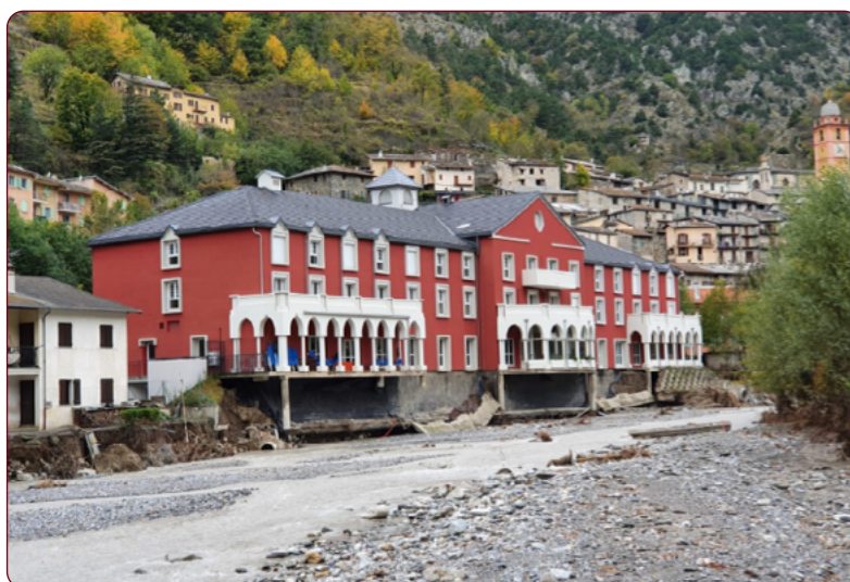
Figure 4.3. EHPAD de Tende impacté par les inondations survenues en octobre 2020. (Source : AFPS)
